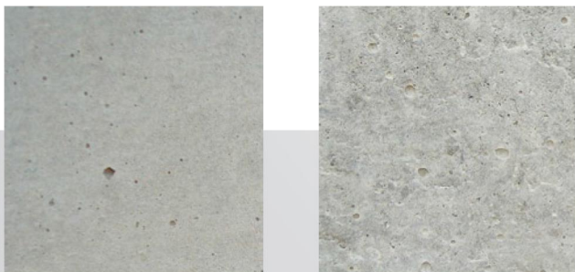
Постепенное образование дефектов на бетонной поверхности
